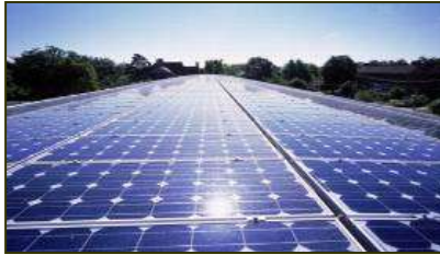
Solar fotovoltaica/ térmica
